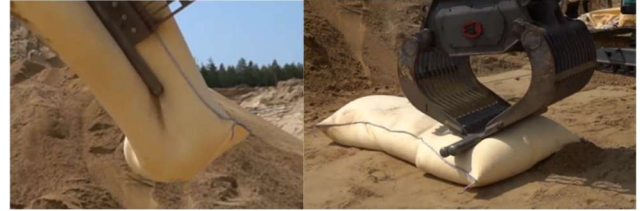
Foto 5. Tensiones en el geocontenedor
